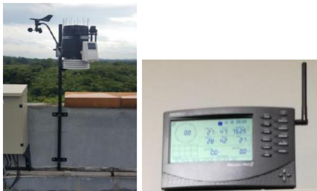
Gambar 6. Weather Station – Unit Outdoor dan Console untuk Indoor
