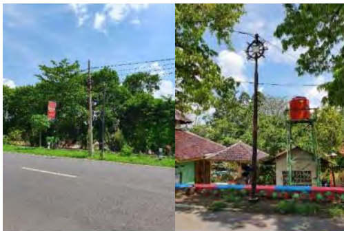
Gambar 6. Jaringan Listrik (sumber: Penulis, 2019)
