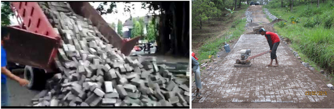
Gambar 1. Proses terjadinya kejut pada paving di lapangan
