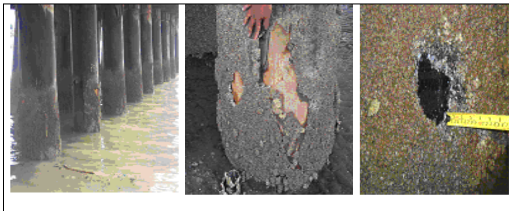
Gambar 1. Biota laut menyerang konstruksi pondasi tiang pancang jembatan (mengakibatkan kerusakan pada struktur beton bertulang)
