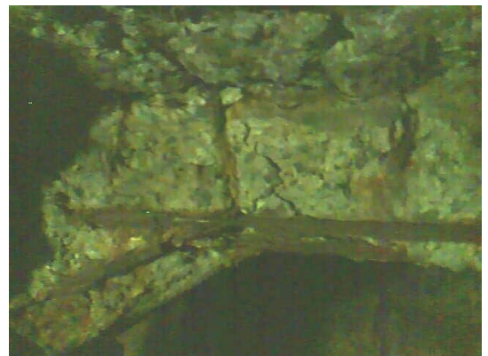
Gambar 1. Kerusakan yang terjadi pada permukaan beton.
