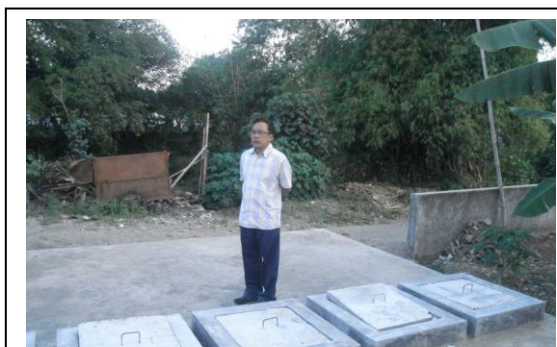
Gambar 12. Instalasi pengolahan limbah komunal Sumber : Priyatmono (2007)
