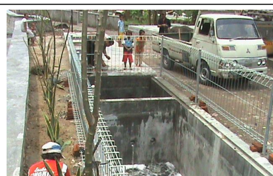
Gambar 13. Instalasi pengolahan limbah komunal Sumber : Priyatmono (2007)
