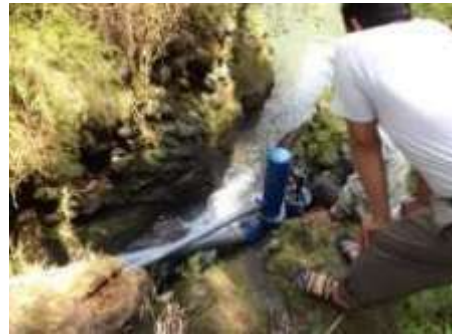
Gambar 11. Pompa Hidram dan Pipa Naik ke Lokasi Perikanan Atas
