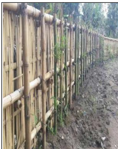
Gambar 3. Kondisi awal konstruksi bio-tanggul terpasang
