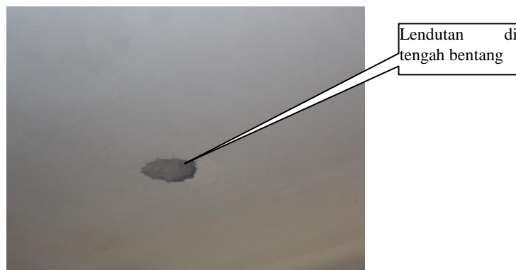
Gambar 2. Plat Lantai 6 bagian bawah dan kondisi lendutan
