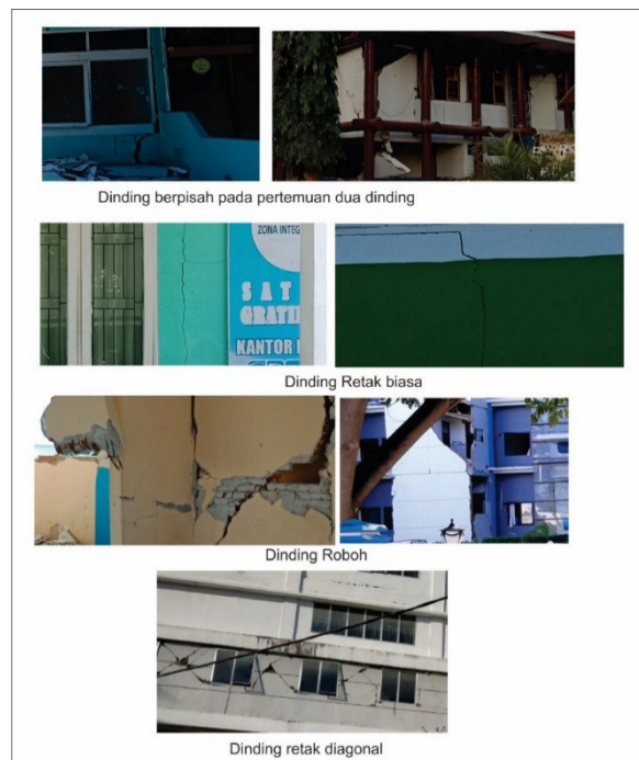
Gambar 17. Pola retak dinding pada bangunan Sumber: Penulis, 2019
