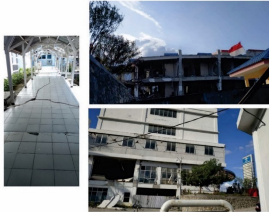
Gambar 11. Kerusakan Rumah Sakit Anutapura
