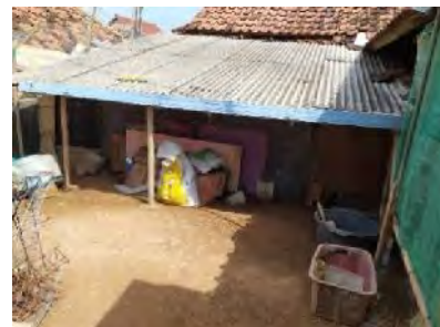
Gambar 7. Keadaan Rumah Terdampak Rob (sumber: Dokumen pribadi, 2019)
