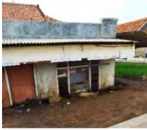
Gambar 9. Keadaan Rumah Terdampak Rob (sumber: Dokumen pribadi, 2019)
