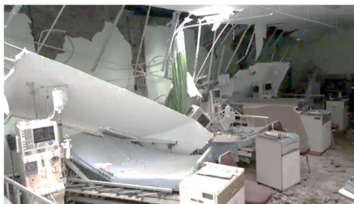
Gambar 1. Kerusakan komponen non struktural gempa Tasikmalaya, 2017 (Zakaria, 2017)
