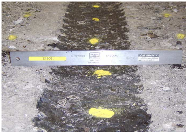
Gambar 9 Rutting sepanjang lintasan roda dan retak di sepanjang sisi pinggir lintasan roda
