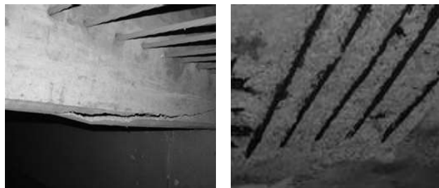
Gambar 1. Kerusakan elemen struktur beton bertulang
