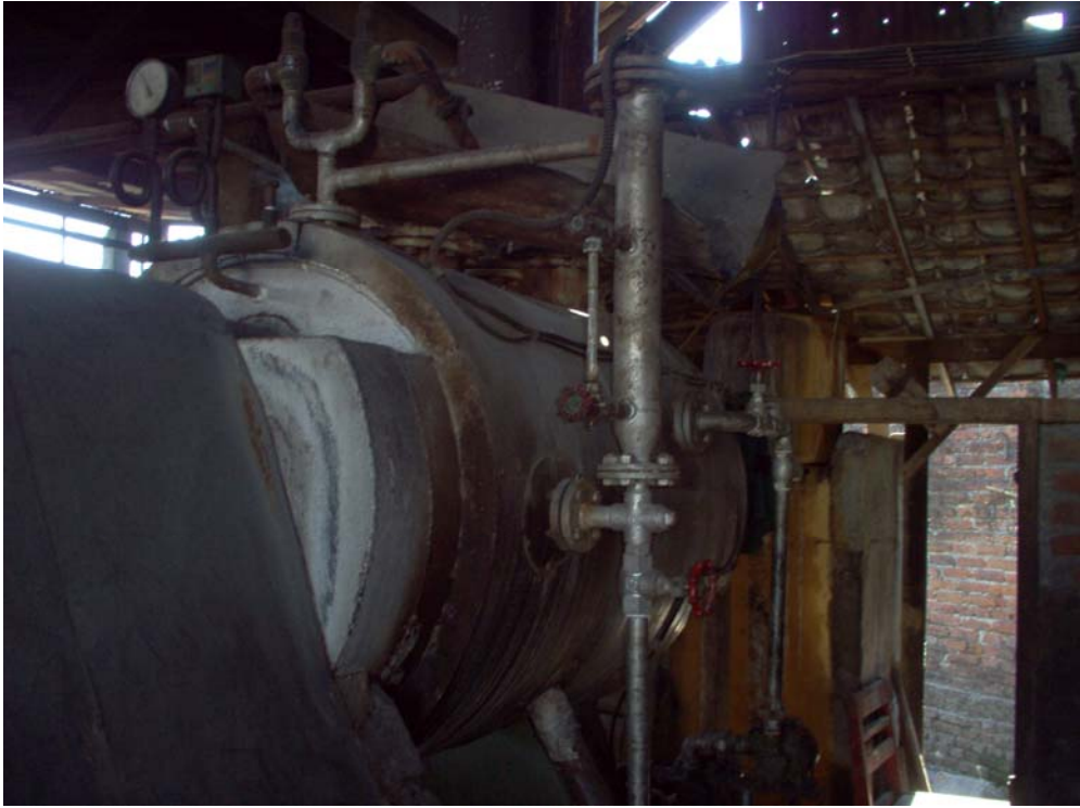
Boiler Di Pabrik Tahu Taman, Sidoarjo
