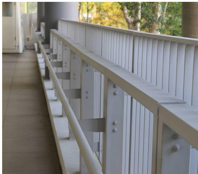
Gambar 8. Handrail tidak hanya disediakan pada area tangga dan ramp, namun juga di jalur sirkulasi lain.. Foto: Parmonangan Manurung
