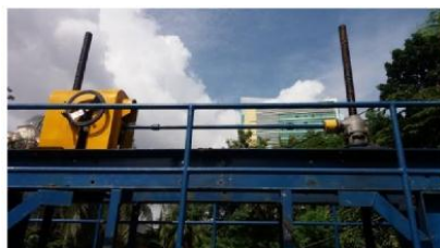
Gambar 3.1.2 Pintu Air Kali Tangki Menggunakan Sistem Motor Penggerak.
