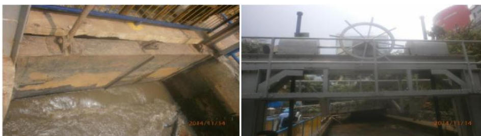
Gambar 1. Pintu Air Kali Tangki Sistem Manual.
