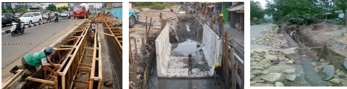
Gambar 1. Pembangunan drainase menggunakan metode pembetonan setempat ( In situ ), beton pracetak ( Precast ), Pasangan Batu.
