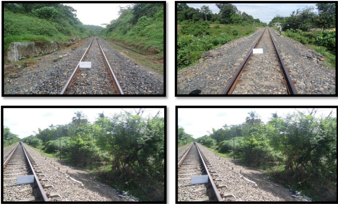
Gambar 5. Kondisi Daerah Rawan Longsor dan Tanah Tidak Stabil
