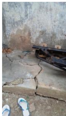
Gambar 3. Retakan tanah yang menyebabkan dinding rumah retak
