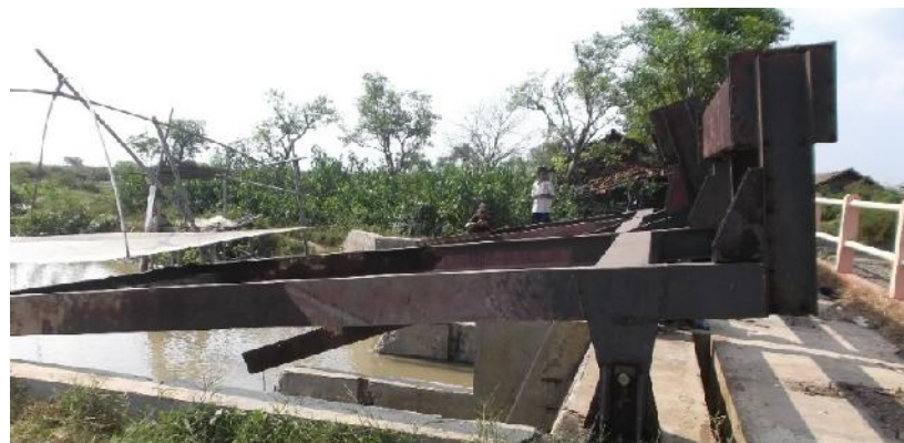
Gambar 2. Kondisi tanggul terluar di Desa Surodadi
